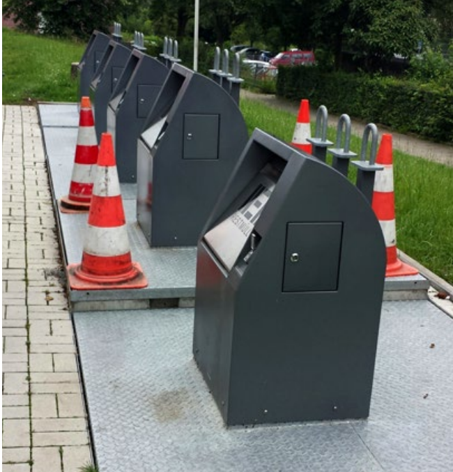
Aufgetriebene Betonwannen; Quelle: HEB Hagen
