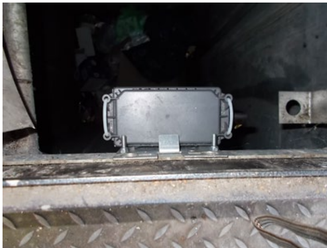
Eingebauter Füllstandssensor; Quelle: Stadtreinigung Hamburg (SRHH)
