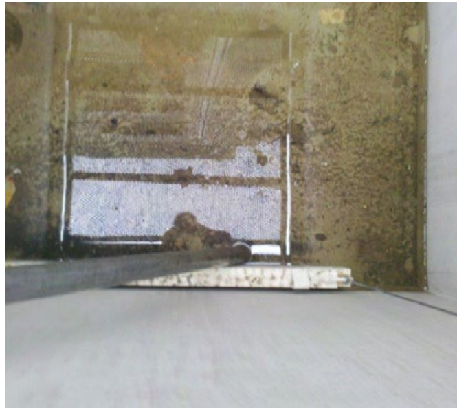
Beschädigung des Bodenbelags durch Stützfuß; Quelle: AWB Köln GmbH
