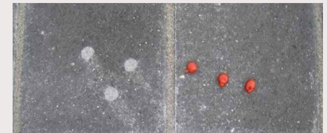
Pflasterfläche mit frischen Ketchupflecken (rechts) und durch Ketchup verursachte Ätzstellen (links) auf einem Pflasterstein mit betonglatte Oberfläche
